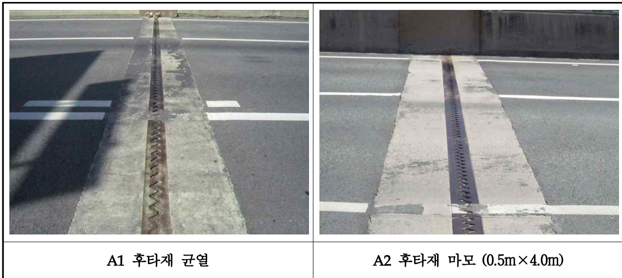
【사진 3.141】 신축이음장치 손상현황
